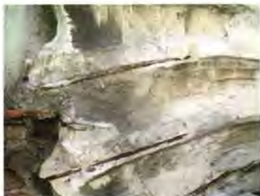
Queste due foto rappresentano il compendio di tutte le forme di degrado che la facciata del Michelazzi ha subito nel tempo. Sono infatti evidenti, erosioni da dilavamento e decoesione delle malte, croste nere, fratture, distacchi e ferri d'armatura esposti.
