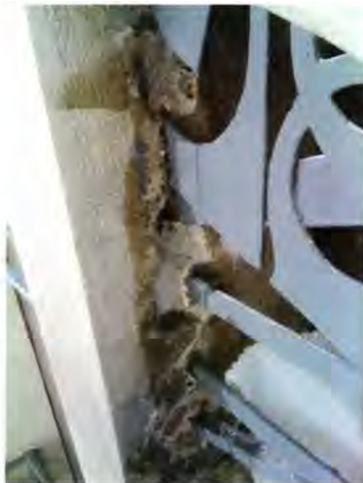
Uno dei numerosi infissi metallici che arricchiscono la facciata dopo la rimozione delle malte superficiali di allettamento rese instabili dalla dilatazione del ferro.
